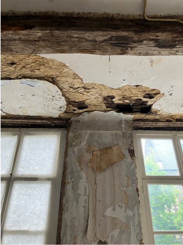
Foto: achterstallig onderhoud kan voor veel schade zorgen in het monument
