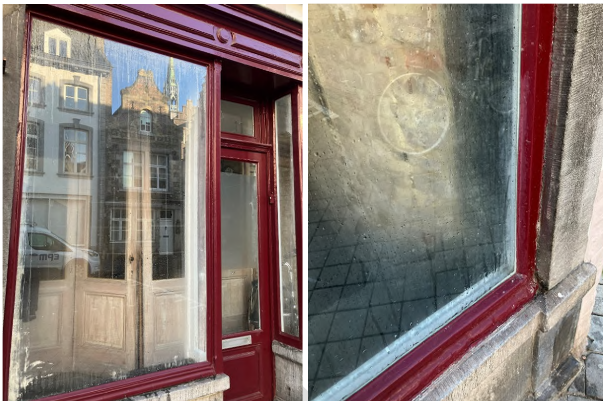
Foto's: condens op de binnenkant van de ruit. Condens geeft aan dat er te weinig geventileerd wordt.
