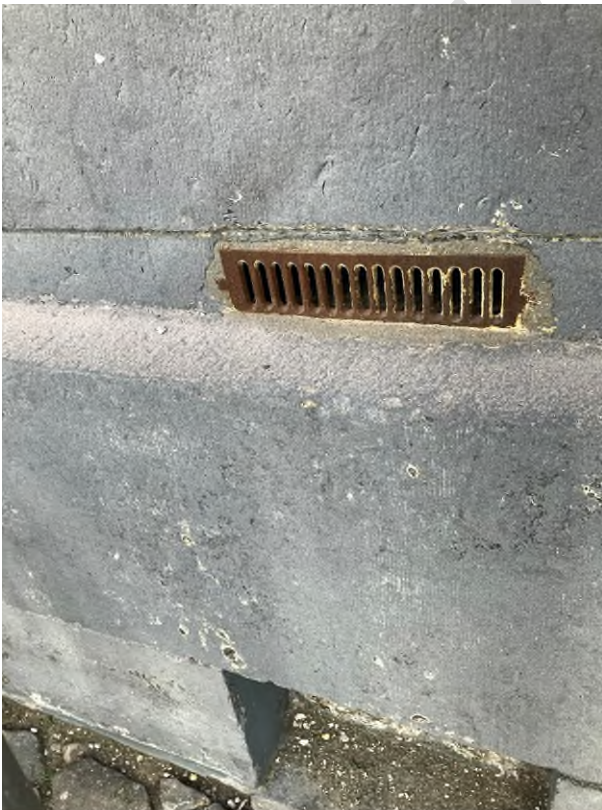
Foto: rooster in bestaande gevel
