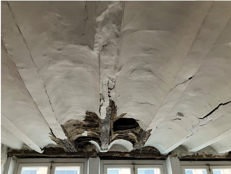
Foto: beschadigd troggewelfd plafond
