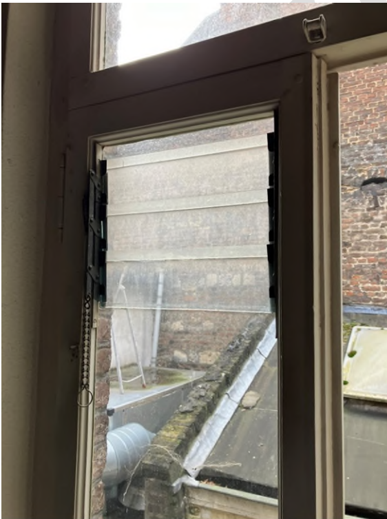
Foto: Louvre glasdeel ten behoeve van ventilatie. Veel toegepast in het verleden. Dit verschijnsel verdwijnt uit het huidige straatbeeld.
