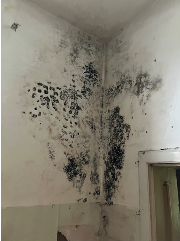
Foto: schimmelvorming aan de binnenzijde van gemetselde muren door achterstallig onderhoud en door te weinig ventilatie.
