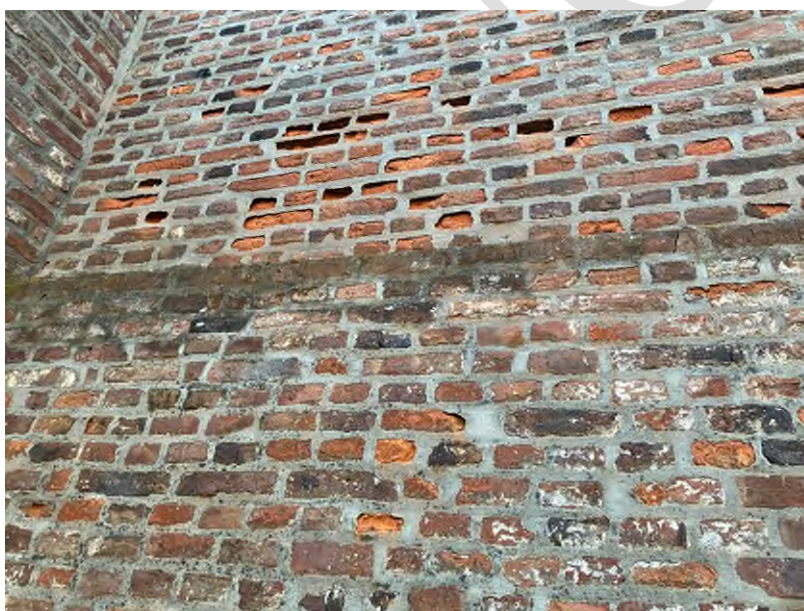
Foto: metselwerk met voegwerk op basis van cement. Door de hardheid van het cement gaan de zachte bakstenen zich opofferen en verpulveren/ verpoederen.
