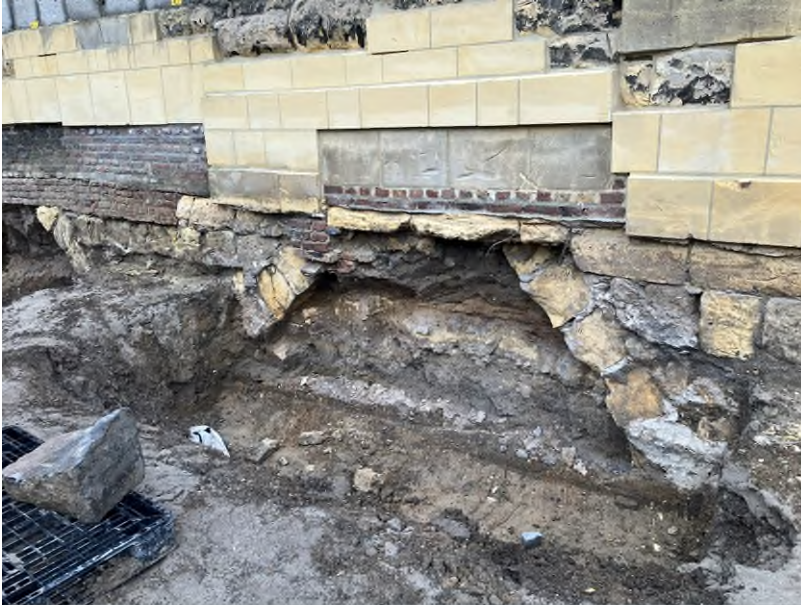
Foto: fundering walmuur opgebouwd uit mergelwerk, hardsteen, metselwerk. Getoogde delen zijn zichtbaar. Deze delen van de muur behoren achter en onder een aardepakket te zitten.
