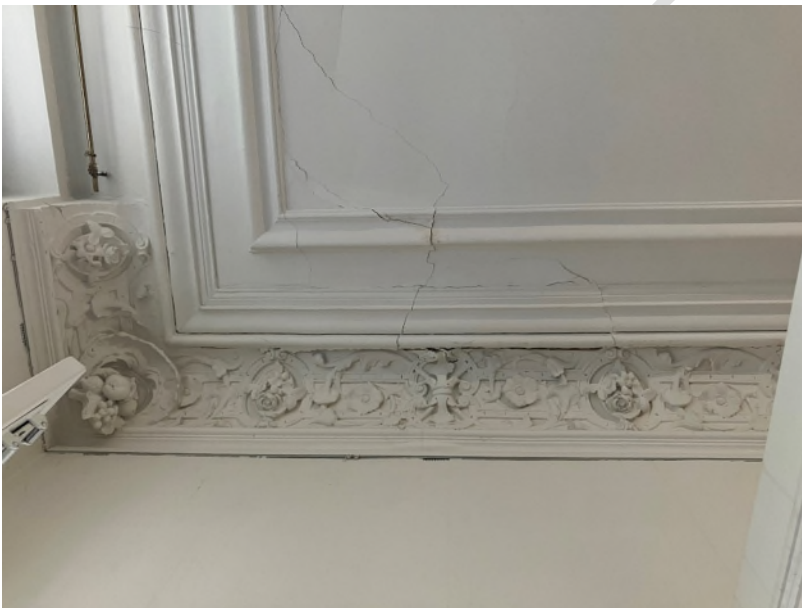
Foto: rijk versierd plafondlijst met scheuren. Waarschijnlijk is er schade aan de dragende constructie boven het plafond.
