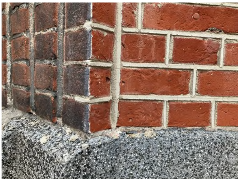
Foto: gestraald metselwerk in aanzicht en niet gestraald metselwerk om de hoek. Door het stralen wordt de baksteen poreuzer en zullen vochtproblemen en ander schade typen sneller optreden.
